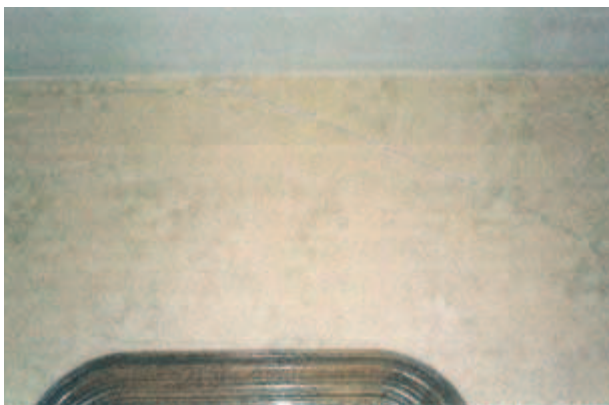
Fissuration intérieure, tapisserie déchirée - Maison André.
