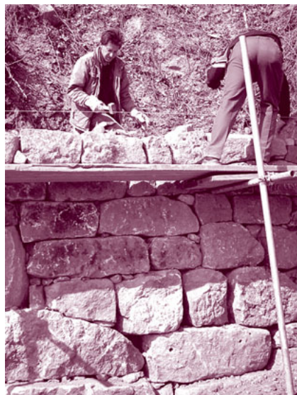
Domaine Schlumberger dans les Vosges : deux maçons remontent un mur de soutènement en assise de gros blocs.
