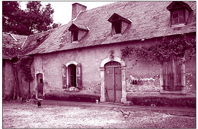
Une maison ancienne dégage une sensation d'humidité d'autant plus grande qu'elle a une utilisation épisodique.
