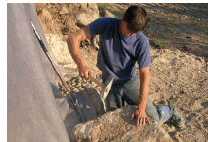
Figure 82 Ils sont retaillés si nécessaire.
