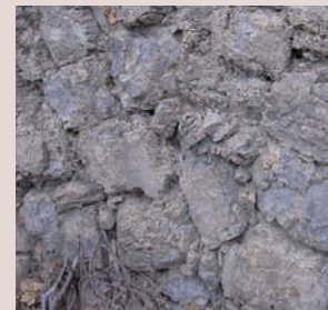
Figure 49 Mur de soutènement dont la pierre est décomposée par le gel.
