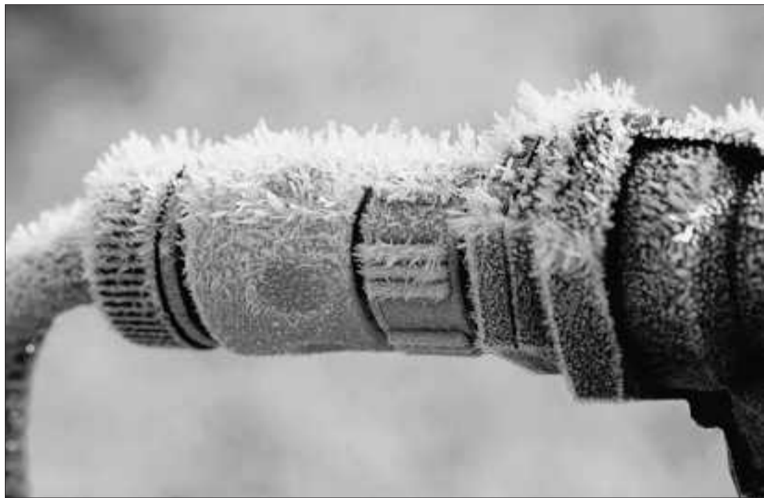
■ Par les températures qui s'annoncent, l'IRM recommande de protéger robinets d'eau et canalisations exposés à l'extérieur.
