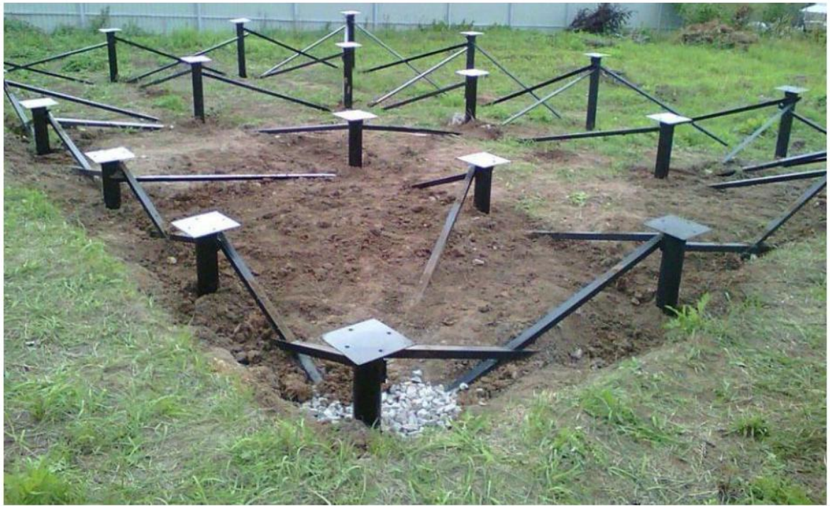
Montage des modules sur pieux vissés avec un minimum d'impact sur l'environnement sur les espaces déboisés de la parcelle (Source : SPL Martinique Energies Nouvelles)
